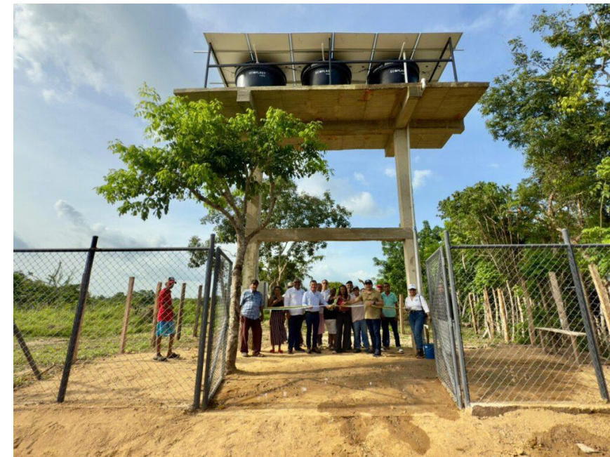
Corporación Autónoma Regional de los Valles del Sinú y del San Jorge Fuente: PV Magazine - Instalan en Colombia pozos solares que amplían el acceso al agua potable en comunidades rurales 5
