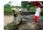
El puente del sector Tórtola Viejo, en Siquirres, quedó destruido. Alejandro Hernández
